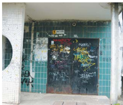
Двери подъездов нуждаются в покраске.
