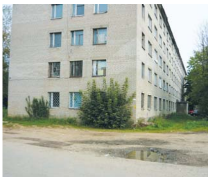
Отмостку общежития АХПК необходимо отчистить
