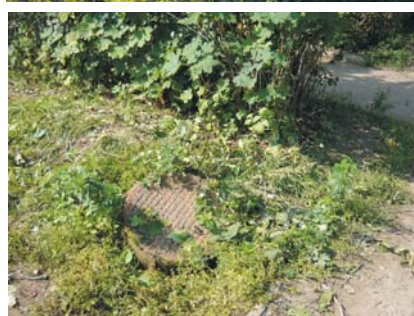
Пос. Южный: необходимо убрать плиты, заделать канализационный люк.
